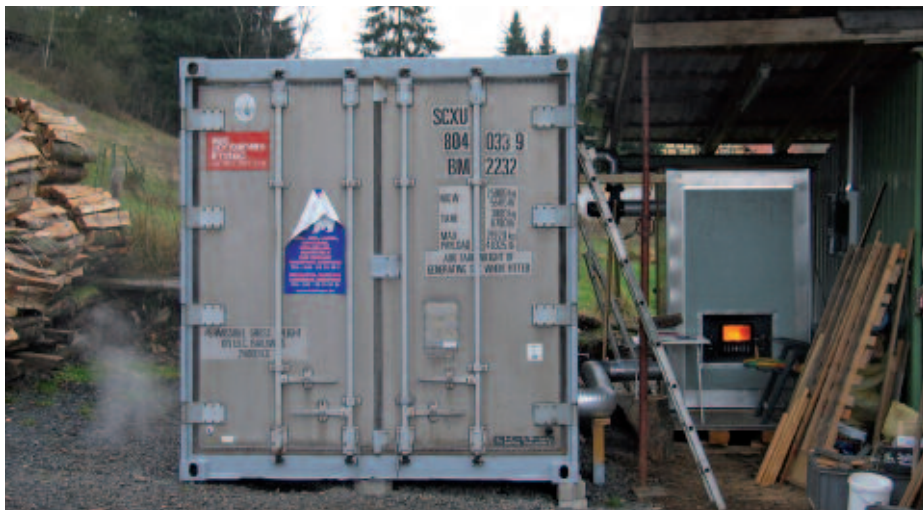
Ein Umlufttrockner mit Restholzverwertung im handbeschickten Warmluftofen (rechts im Bild) ermöglicht bis 130 Grad Zulufttemperatur.
